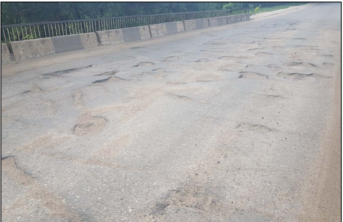
Рис.10. Выбоины в покрытии до бетона защитного слоя. Водоотводные трубки скрыты асфальтобетонным покрытием
