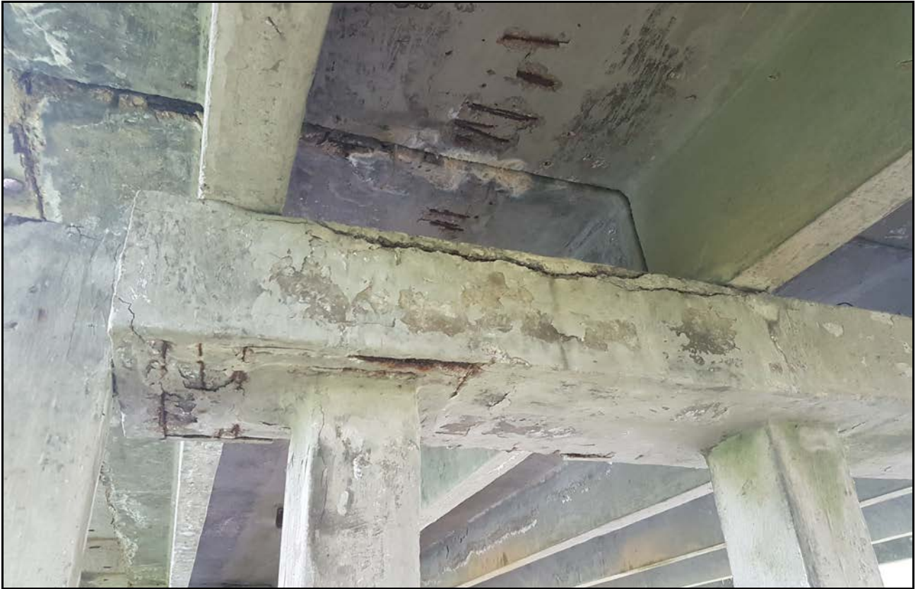
Рис.9. Разрушение защитного слоя бетона с оголением арматуры, коррозия арматуры
