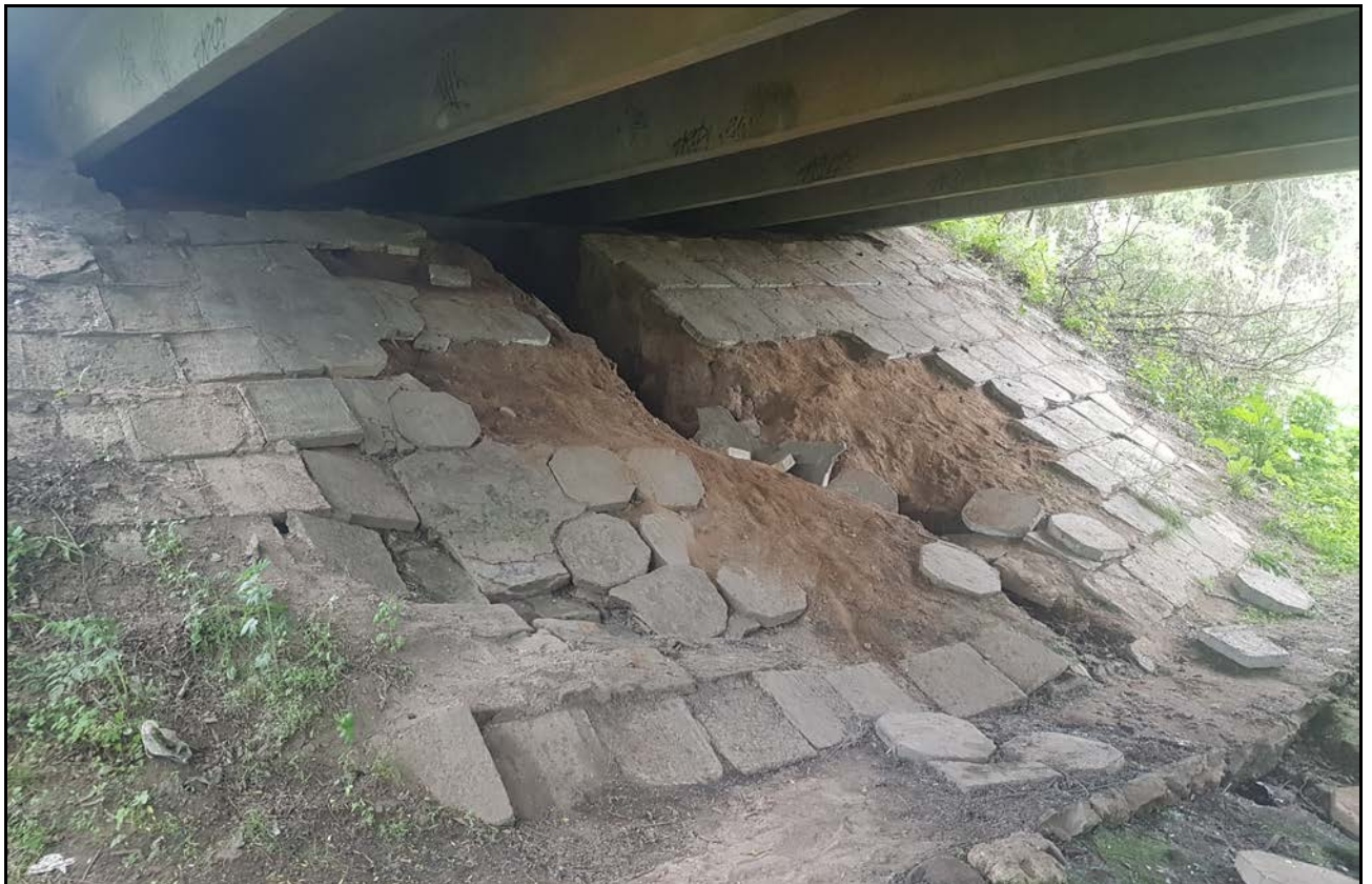
Рис.8. Размыв насыпи конуса, разрушение укрепления (опора 4).
