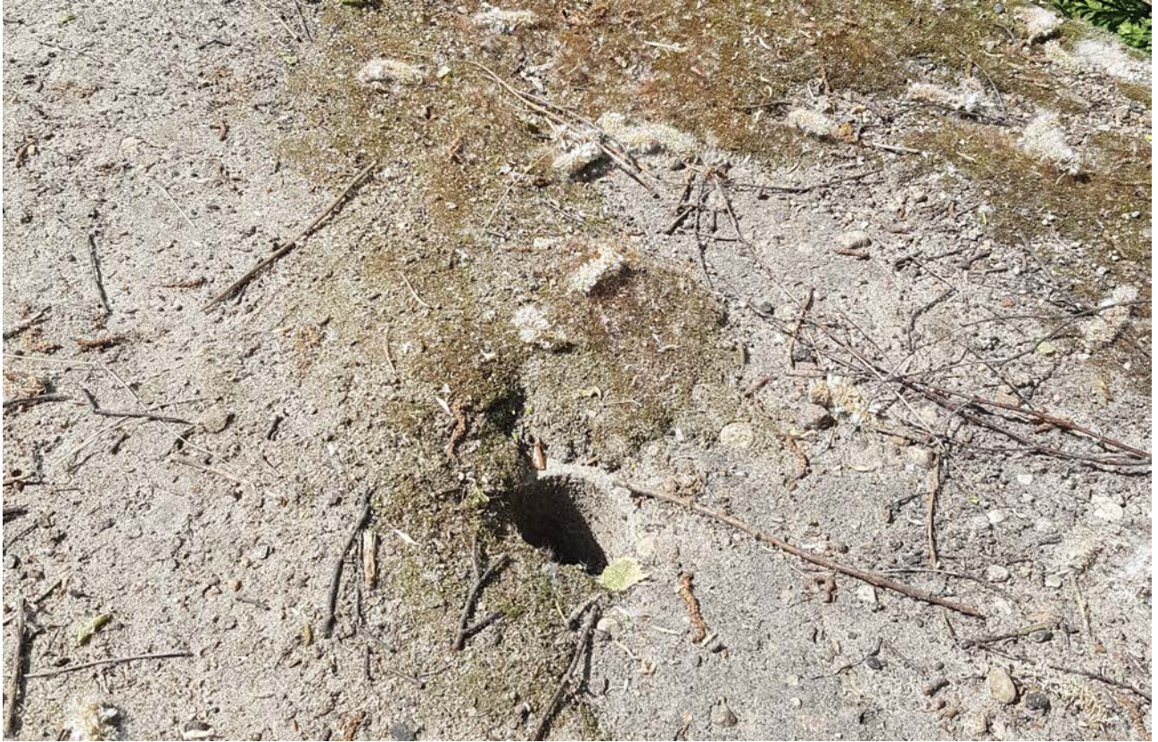
Рис.11. Загрязнение тротуара, отсутствуют решетки на водопропускных трубках.
